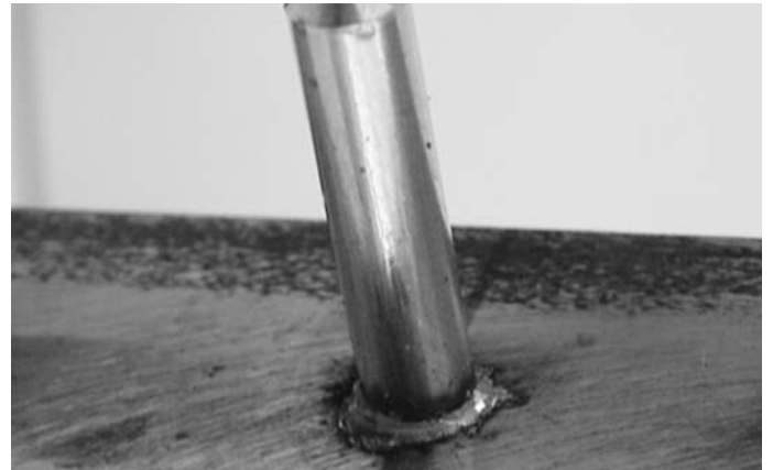
Abb. 10 Prüfung der Schweiss-Stelle durch Sichtkontrolle (umlaufend sauberer, gleichmässiger Schweisswulst) III. 10 Vérification de la soudure par contrôle visuel (entourage propre, cordon régulier)
