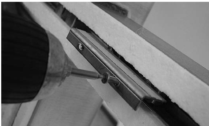
Abb. 19 Einsetzen und Befestigen der Glasauflagen mittels Schraube, auf Brandschutzanker zur Feldmitte Fig. 19 Insérer les supports de verre et les fixer avec une vis sur le boulon d'ancrage anti-incendie vers le milieu du champ
